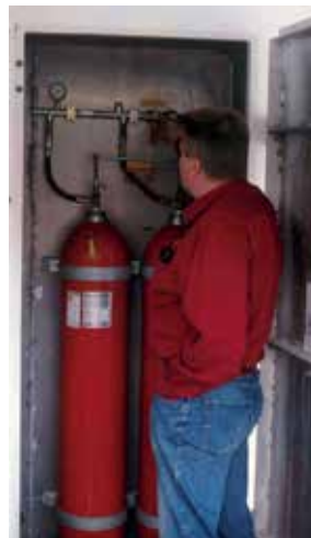
Förberedd släckning, CO 2 för maskinrum.
