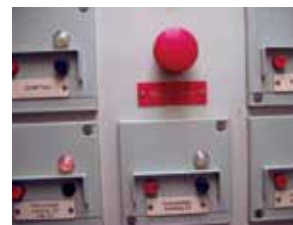
Nödstopp av fläktar.
